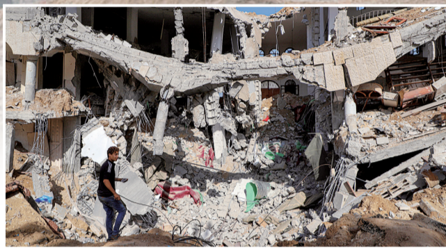
在加沙地带南部城市汗尤尼斯拍摄的被损毁的建筑物
