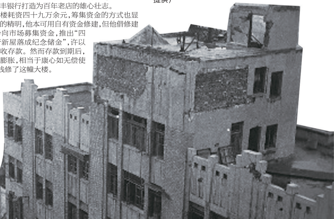
被日机轰炸后的美丰大楼
