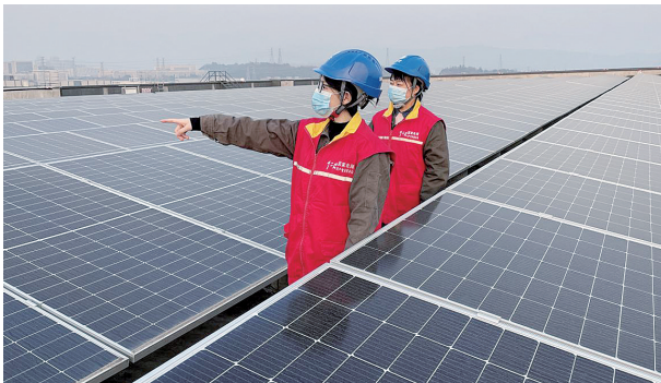
国网北碚供电公司员工在京东方项目一期做投运前检查工作
