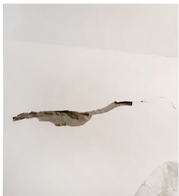
有业主晒出自家的开裂情况，有墙皮脱落。 图片来源：网友
