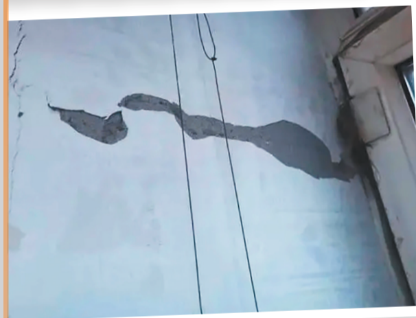
出现裂缝的墙面
