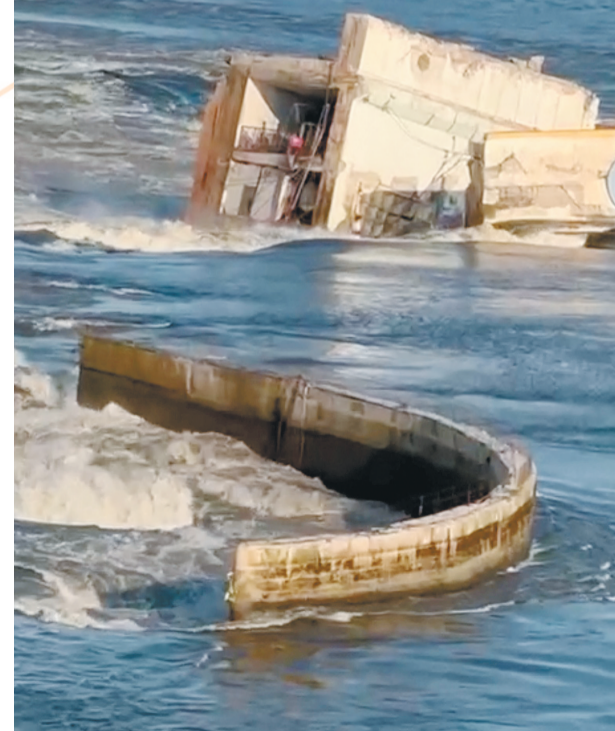
被炸毁的卡霍夫卡水电站大坝旁损毁的建筑 新华社发
