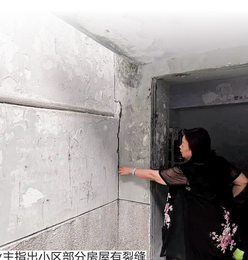
业主指出小区部分房屋有裂缝
