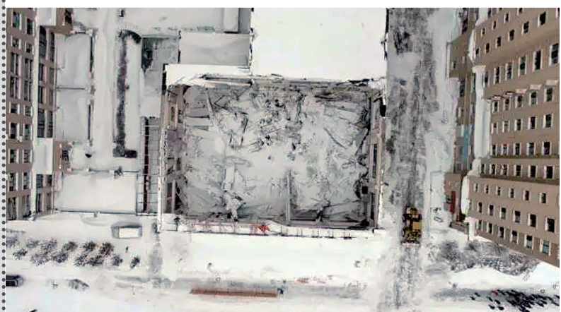
坍塌的体育馆
