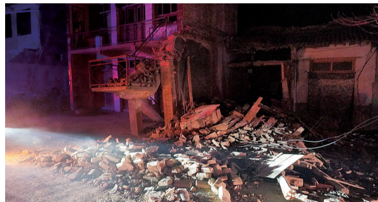
积石山县大河家镇陈家村一处倒塌的房屋
