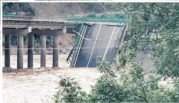
丹宁高速水阳段山阳方向K46+200处严坪村二号桥垮塌现场
