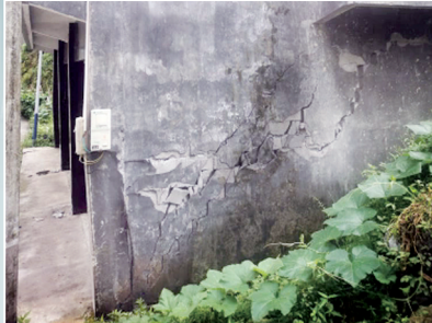
黔江发生滑坡致房屋外墙体裂缝
