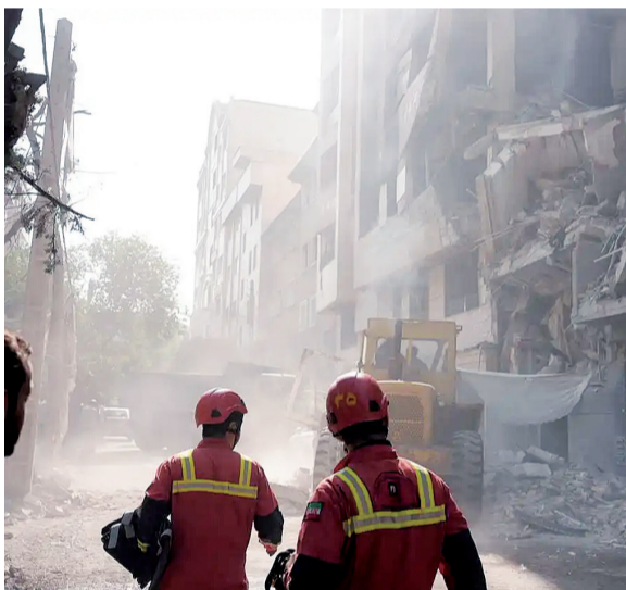
6月13日在伊朗首都德黑兰拍摄的在以军袭击中受损的建筑。
