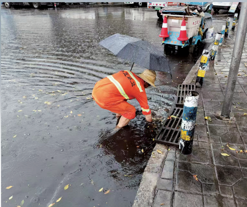
环卫工人在加工区积水路段排水
