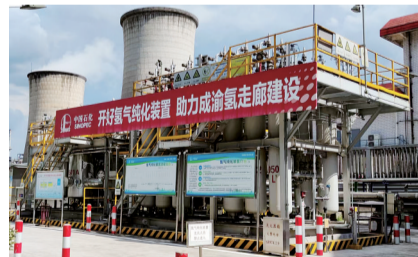
川维化工的氢气提纯装置
