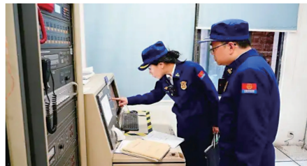
重庆消防报警控制主机正在运行
