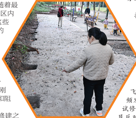
已经停工的电动摩托车充电桩安装场地
