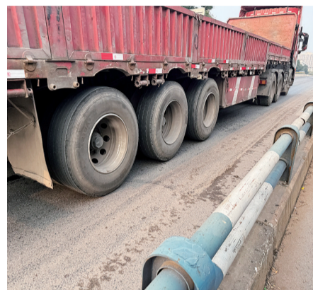
重车碾压易致路面沉降
