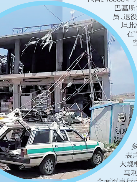
也门塔伊兹省空袭中被损毁的建筑
